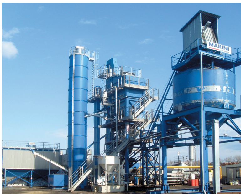
Так внуительно выглядит асфальтобетонный завод «MARINI»
