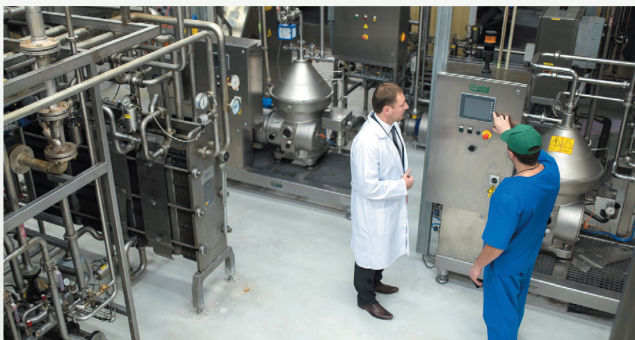
Переработка молока осуществляется на современном сложном оборудовании
