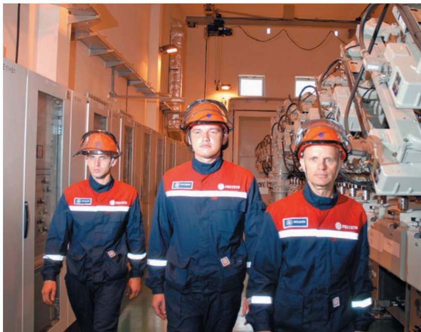
Бригада службы подстанций «Курскэнерго» на ПС 110 кВ «Котельная»
