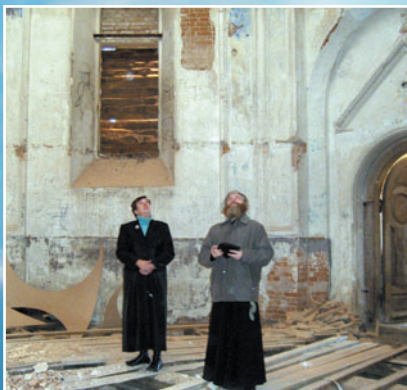
В таком удручающем состоянии находился храм до реставрации
