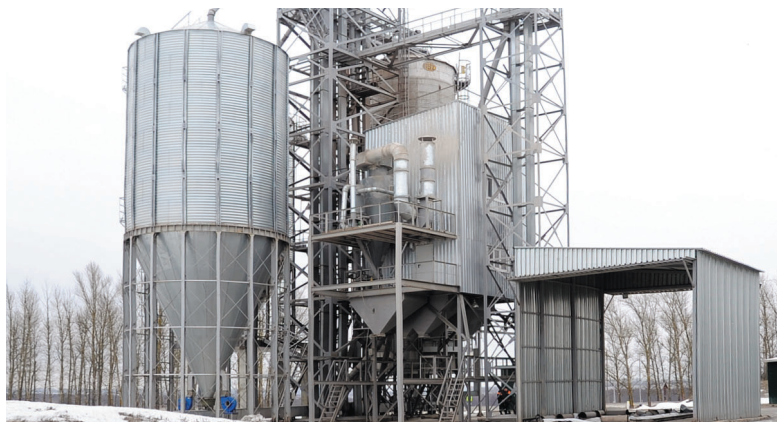
Современный зерносушильный комплекс выглядит весьма внушительно
