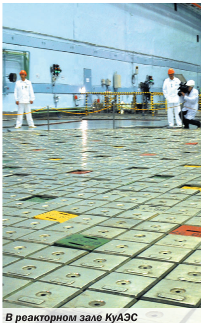
В реакторном зале КуАЭС
