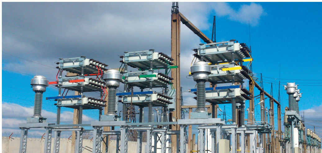
Подстанция «Касторное» оборудована по последнему слову техники, что позволяет надёжно обеспечивать потребителей электроэнергией и снизить в дальнейшем ремонтно-эксплуатационные затраты на ее обслуживание
