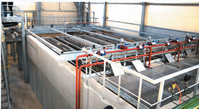
Благодаря установленным фильтрам качество питьевой воды улучшится в разы
