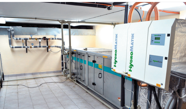
Современные комплексы автоматики обеспечивают поддержание заданной температуры, влажности и вентиляции воздуха
