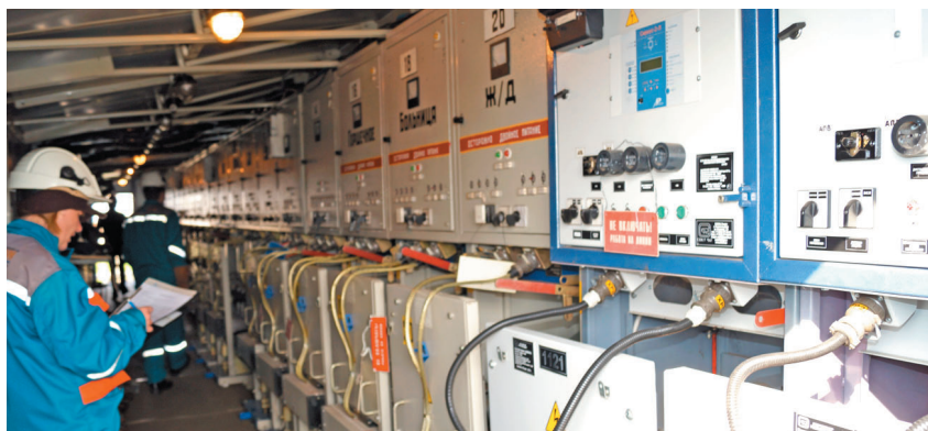
На подстанции 110/35/10 кВ «Горшечное» установлено современное оборудование, обеспечивающее надежное электроснабжение потребителей восточной части Курской области
