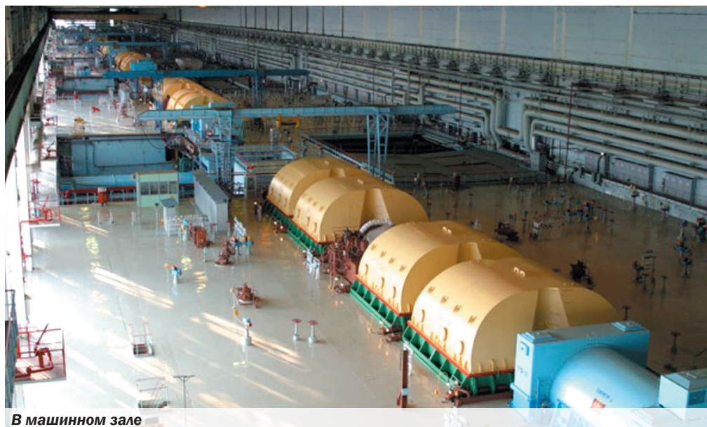
В машинном зале
