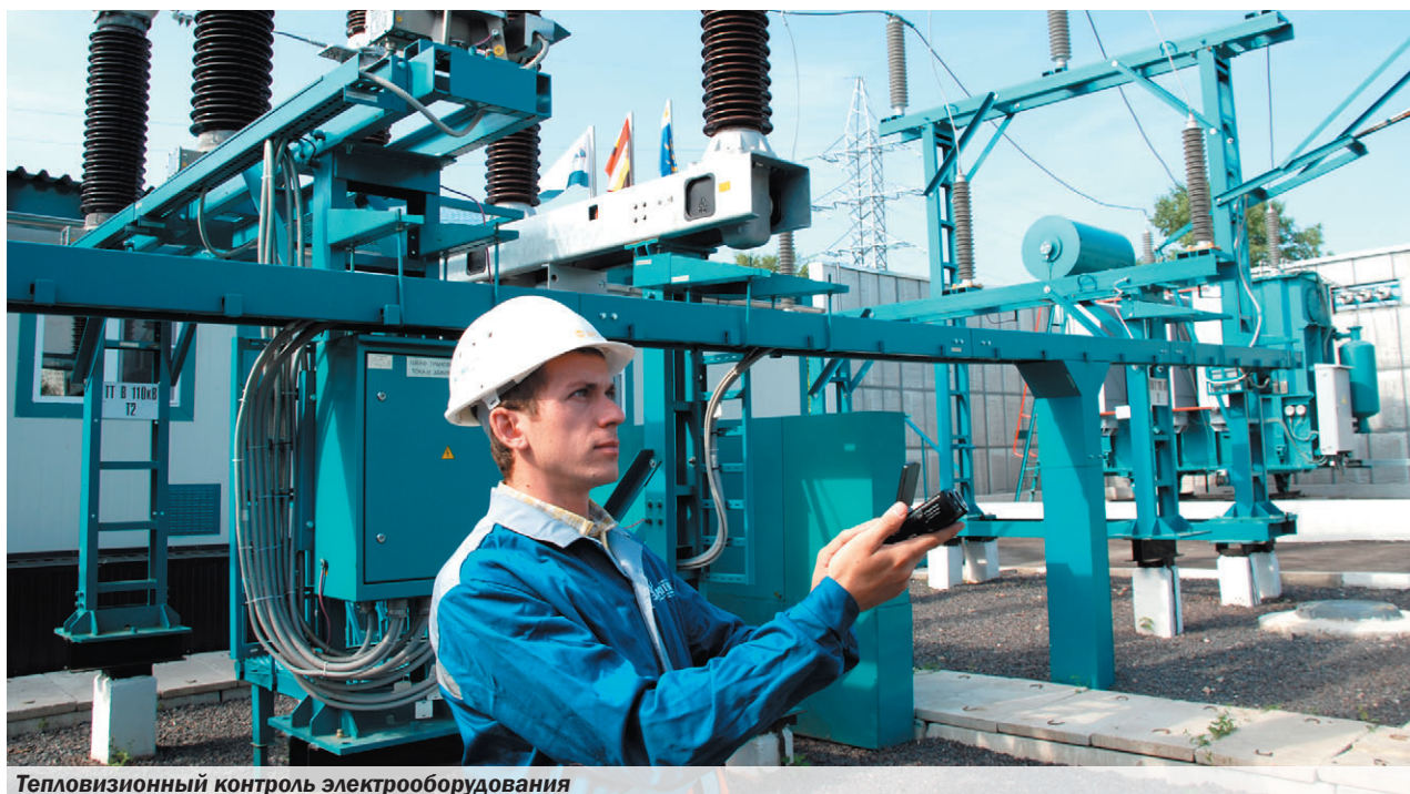
Тепловизионный контроль электрооборудования
