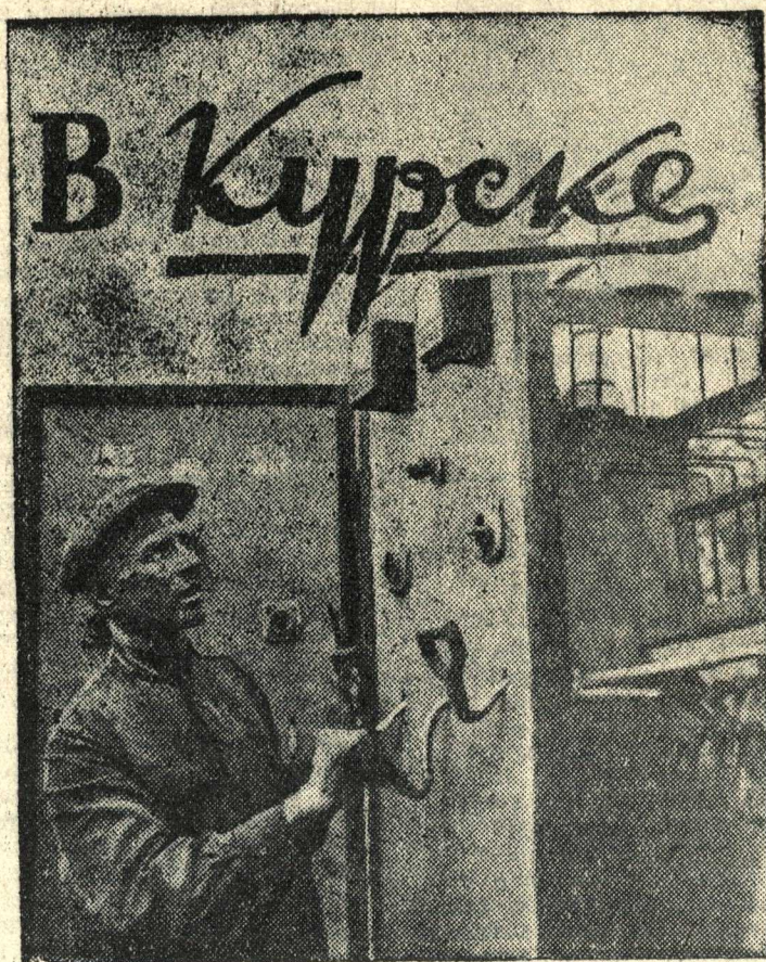
Курская областная мастерская «Сельэлектро» изготовила 55 распределительных щитов для колхозных электростанций. На снимке: электрослесарь Н. Спассенко проверяет распределительный щит перед отправкой. Фото А. Говорова.
