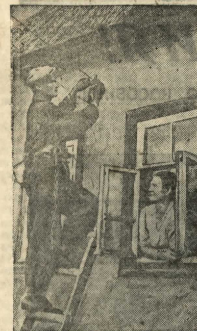
В колхозе «Знамя революции» Лыговского района установлен 500-ваттный усилитель, который обслуживает также соседние колхозы.
